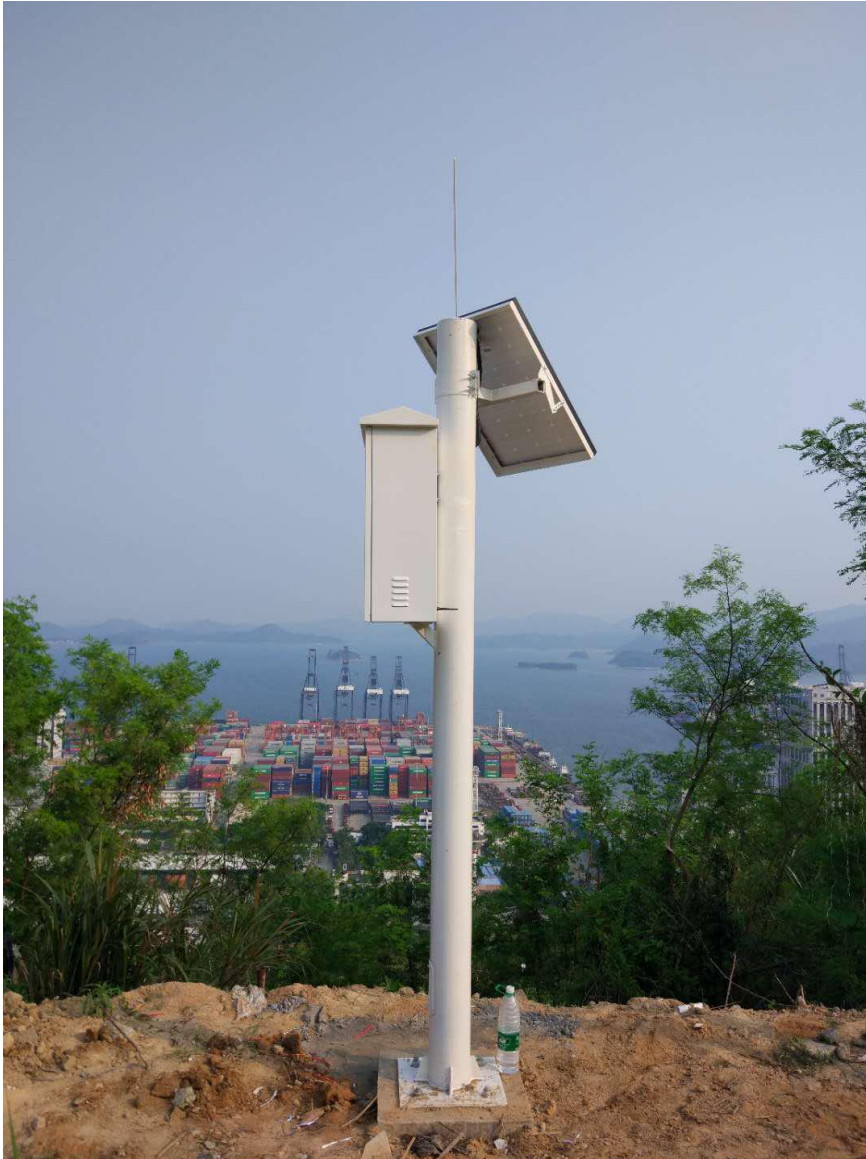
图 6.1 一体化监测站安装在柱体上
